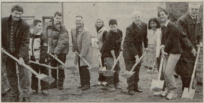
Den ersten Aushub für den Ausbau der Korczak-Schule erledigten Schüler und Erwachsene gestern gemeinsam. ■ Foto: Julia Rau
